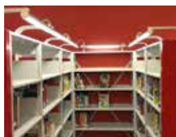
ÉCLAIRAGE À DEL DANS LES ALLÉES
